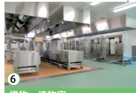
6 揚物・焼物室
